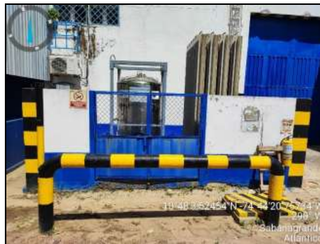
Imagen 140. Tanque de almacenamiento de oxígeno líquido.
