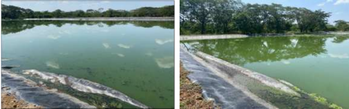
Imagen 38. Elevación de la geomembrana ocasionada por fugas de agua residual hacia el suelo. Lugar: EDAR Suan. Fecha: 14 de febrero de 2024.
