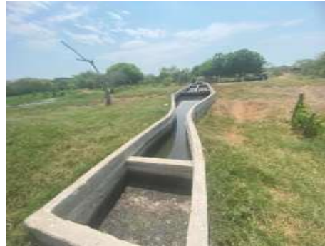
Imagen 35. Estructura de pretratamiento. EDAR Manatí.
