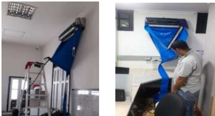
Imagen 208. Mantenimientos preventivos y correctivos.
