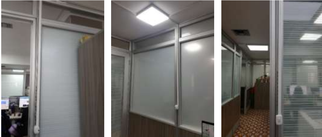
Imagen 203. Sistema de iluminación tipo LED e interruptores en las oficinas del segundo piso de la sede principal.
