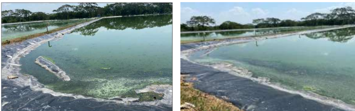
Imagen 37. Elevación de la geomembrana ocasionada por fugas de agua residual hacia el suelo.
