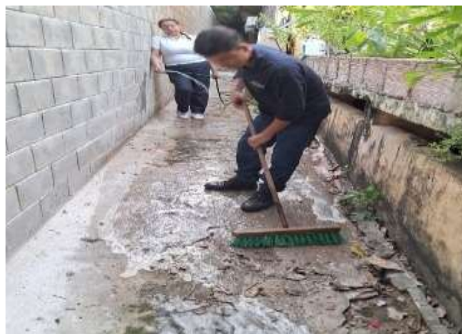
Imagen 197. Intervención y adecuación para condiciones inseguras.
