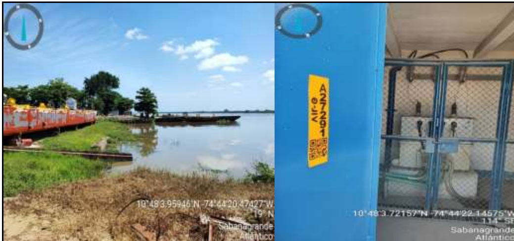
Imagen 139. Punto de acceso y dique seco de la empresa TRANSFLUCOL - Transformador con funcionamiento de aceite dieléctrico.
