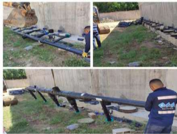
Imagen 41. Montaje manifold hidráulico para la entrada de reactor UASB.
